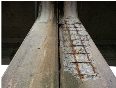
Рис. 1. Приклад оголеної іржавої арматури в залізобетонному мості до відновлення
