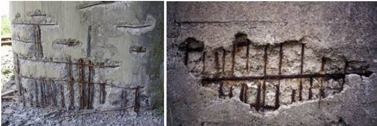
Рис. 1. Приклади оголеної іржавої арматури в залізобетонних конструкціях
