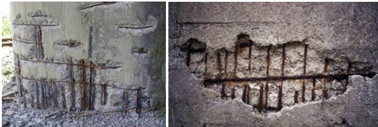
Рис. 1. Приклади оголеної іржавої арматури в залізобетонних конструкціях
