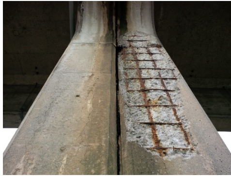
Рис. 1. Приклад оголеної іржавої арматури в залізобетонному мості до відновлення
